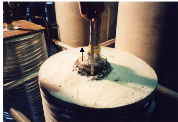
写真-7 クサビ型アンカー引抜け状況
