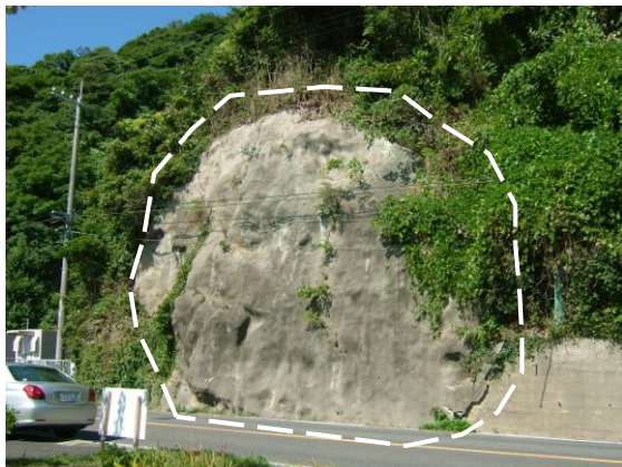
写真-1 岩盤滑落
