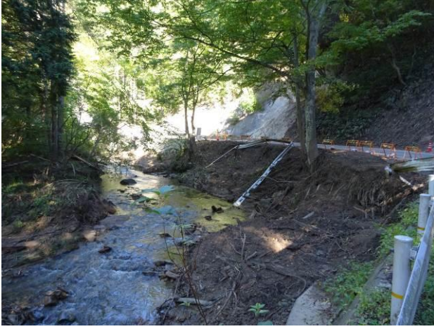
水衝部の浸食
