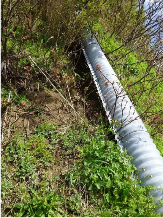
コルゲート水路の浮き
