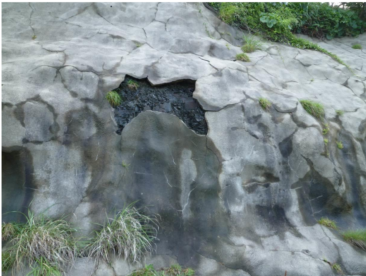
○湧水箇所を中心とした剥離
