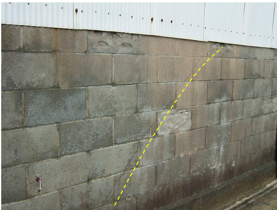
○ブロック積…原因不明のクラック
