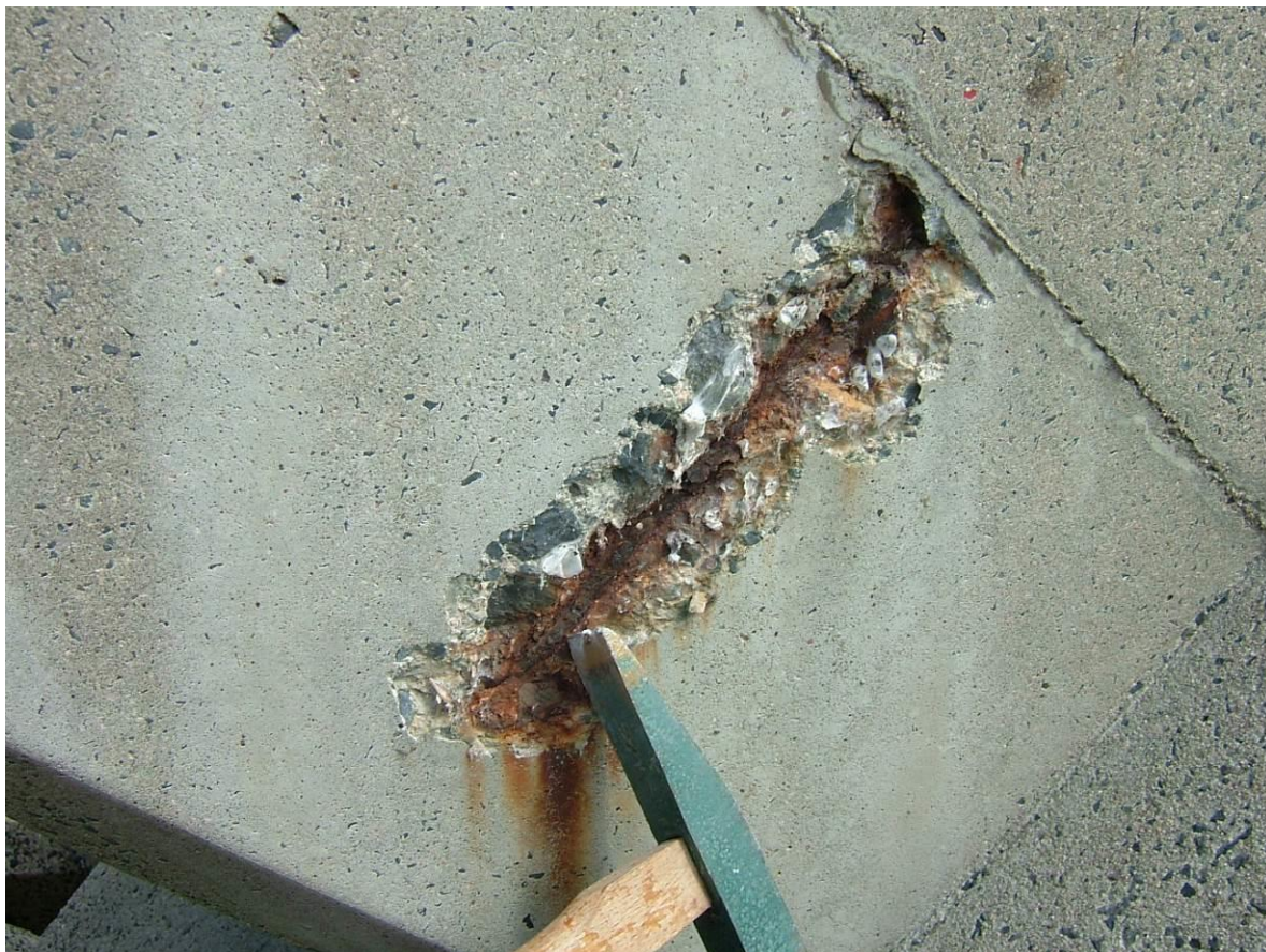
○コンクリート表面がはらんでいる箇所の内部状況
