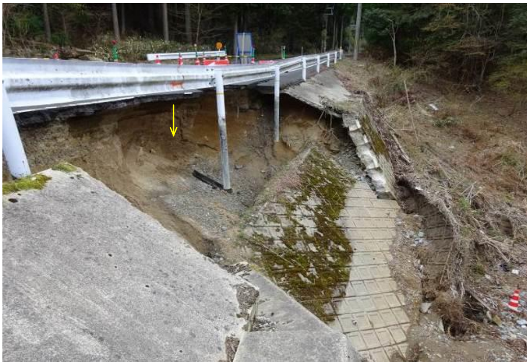
路体の崩壊状況（幅 10m. 半盛土？区間. 矢印はパイプ位置）
