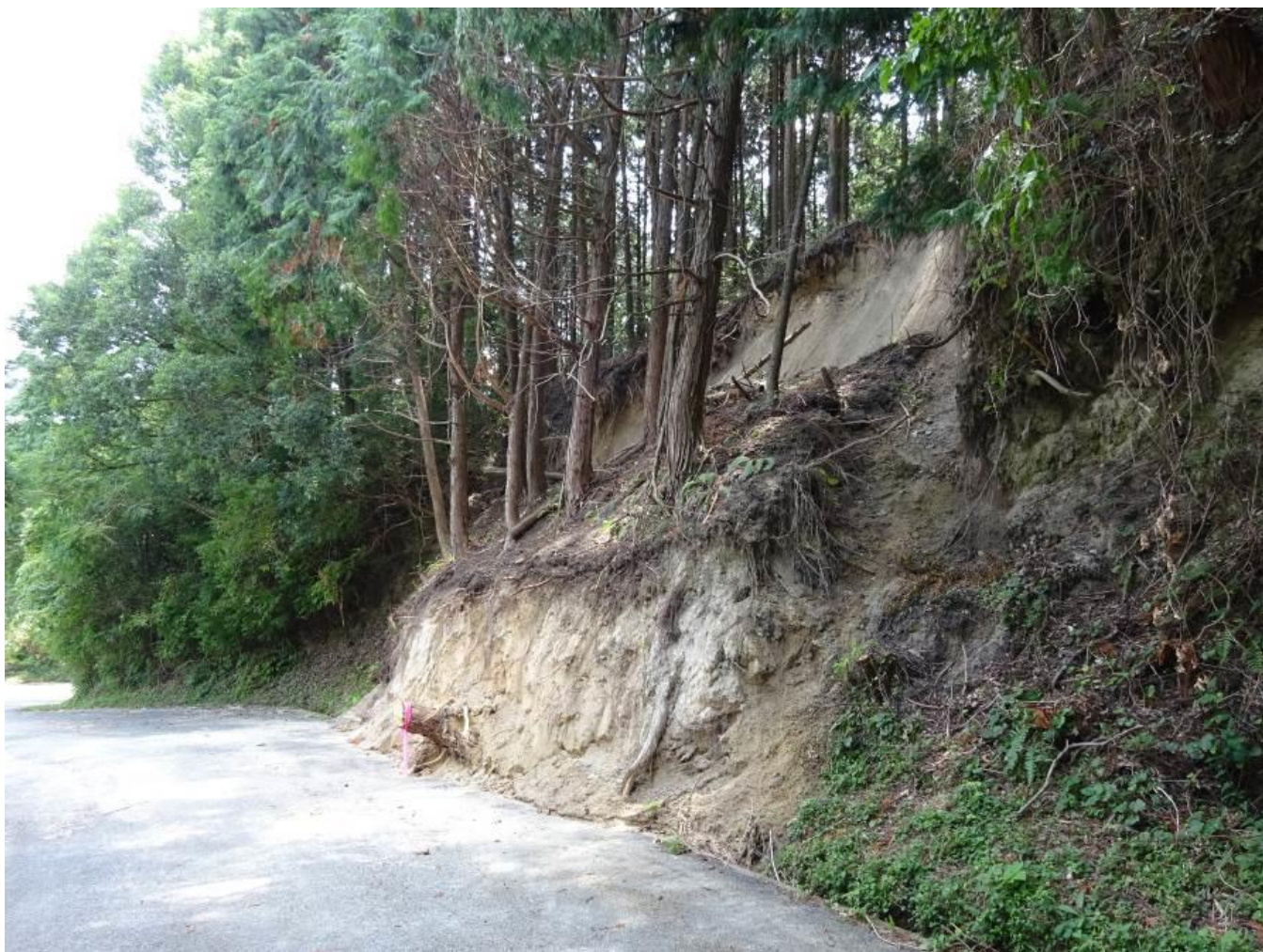
立木根系が、表層すべりの抑止にあまり期待できないことを示す例 (すべり面⇨硬い地盤 →根が進入できず、むしろ不連続面での剥離を助長)
