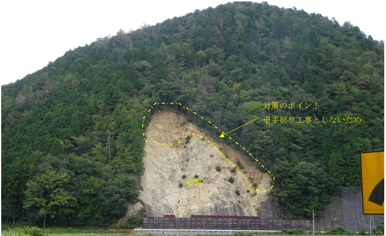
モルタル吹付による復旧後の退行性崩壊
