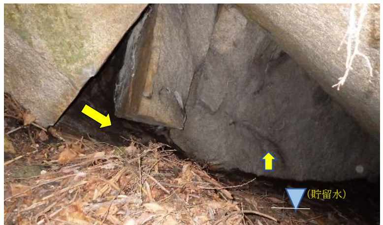
同上, 側壁部の剥離状況 ※移動層の, すべり面からの局部的浮上がり
