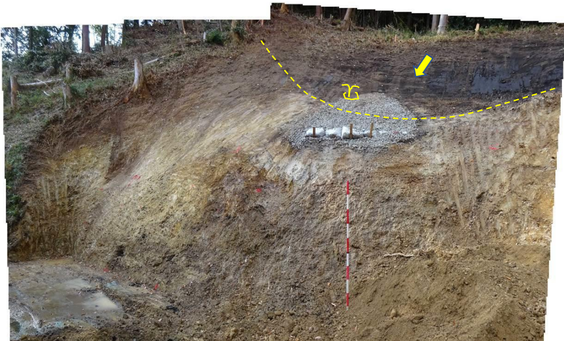
古い地すべり末端付近の切土面における湧水点(2019.4 掲載写真)
