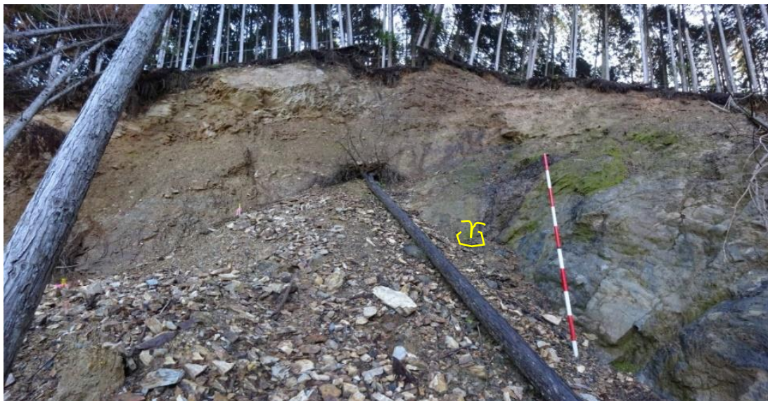
滑落崖直下(冠頭部と側壁部の交点付近)における、唯一の湧水(2020.5 掲載写真)
