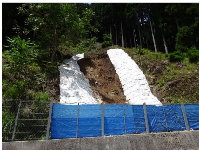
② 蛇紋岩（中央部分が再崩落＝深層化）
