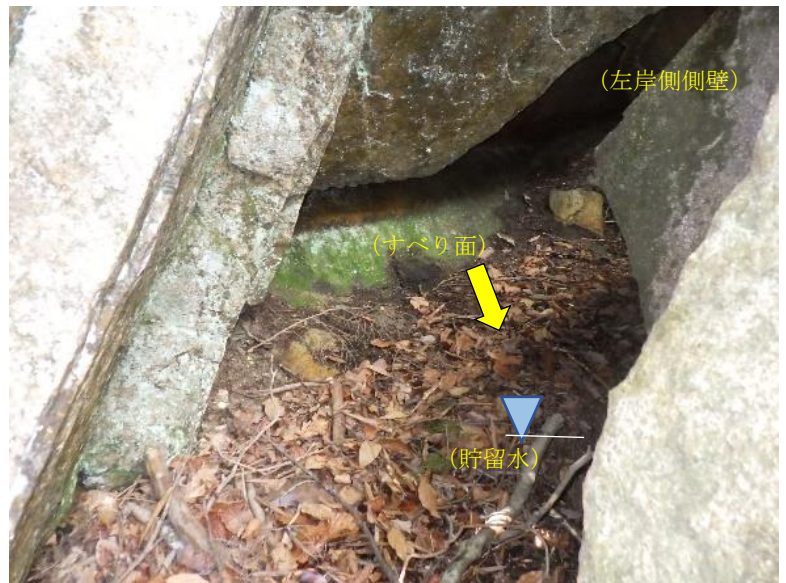
陥没帯内左岸側 : すべり面 (粘土層なし) と貯留水
