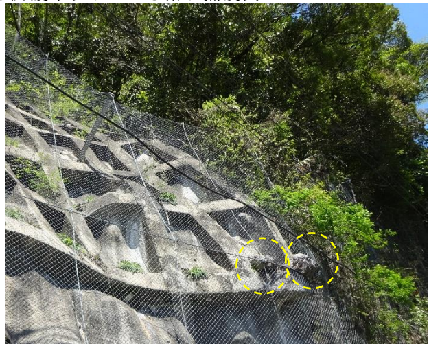
○防護ネットによる落石捕獲例
