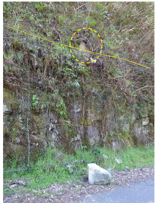
○法肩（防護ネット直上）からの落石
