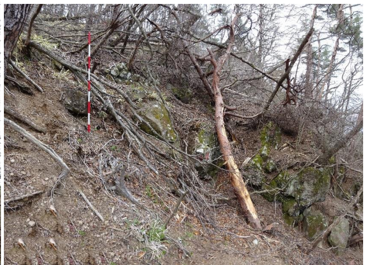
②起点側崩壊跡
