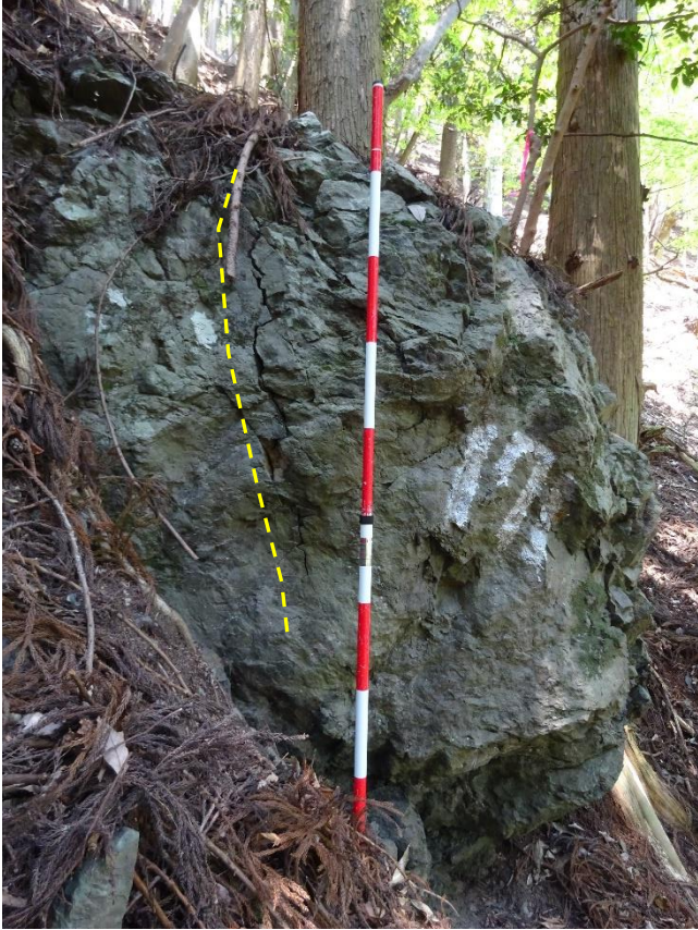
上部からの剥離（片岩類，傾斜 80^\circ ）
