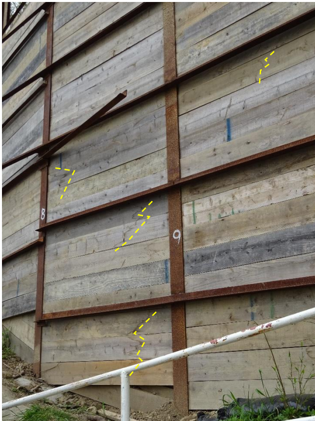
仮設防護柵：木矢板の割れ …金網等を併用するか、鋼材間隔を密にする
