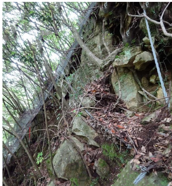
旧表層崩壊地（層厚 1~2m）の残留岩塊対策における破損
