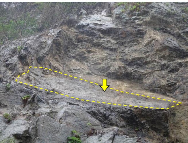
写真-3.2.21 割れ目の多い露岩の剥離
