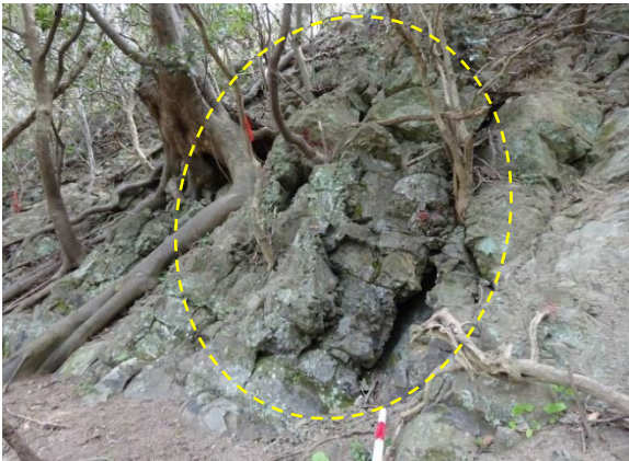
写真-3.2.4 根系による露岩斜面の浮石化
