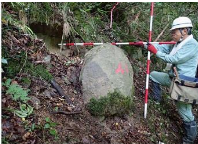
写真-3.2.26 水圧により押し出された岩塊
