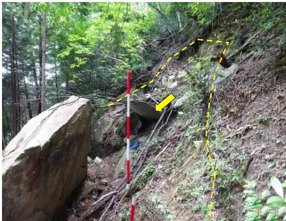
写真-3.2.10 局部的すべりによる落石
