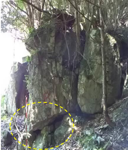
写真-3.2.14 脚部浸食による不安定化
