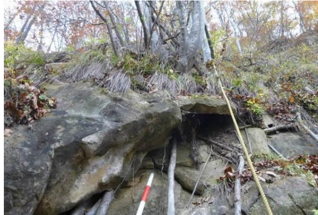
写真-3.2.3 立木根系による節理面の剥離
