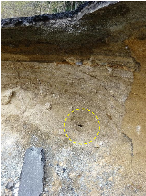
図 3.2 道路盛土部？の崩壊（延長 10m） ……1 個のパイプ（円内）から、盛土材背面に順次水圧が伝わった可能性が考えられる
