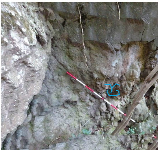
図 3.4 火砕岩層内を切る地すべり（幅 18m, 層厚 3.5m） ……側壁部破断面に滲むような湧水あり （すべり面粘土なし）
