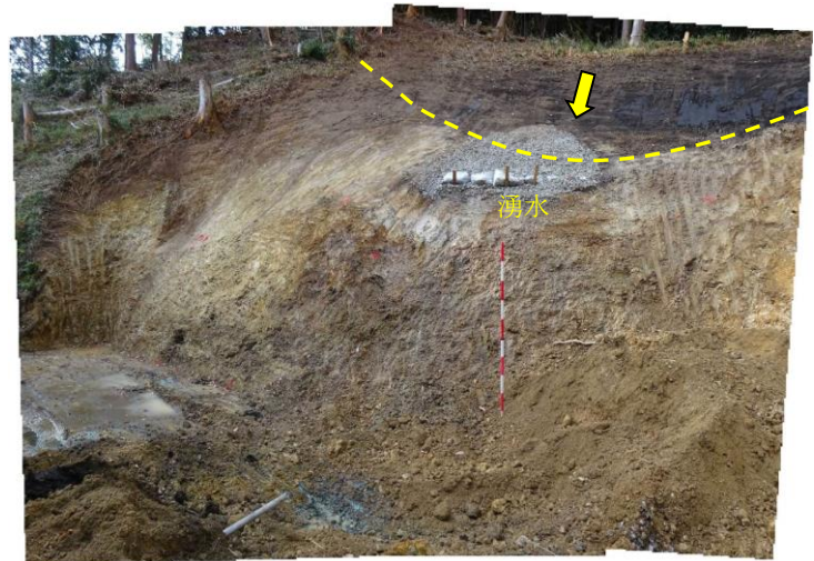
図 3.3 地すべり横断面のすべり面付近の湧水（泥岩層） （すべり面粘土なし）
