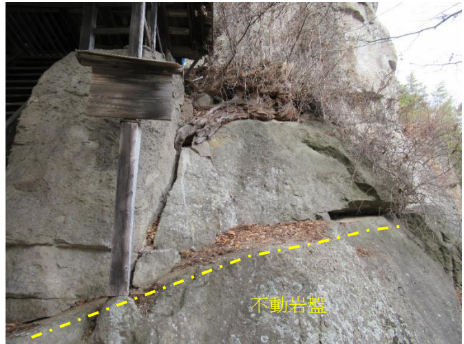
同左, 脚部正面の剥離状況
