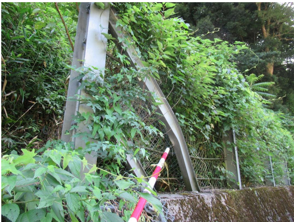
落石地点より 39m 地点の端末支柱（控え材は、右回転を伴う座屈）
