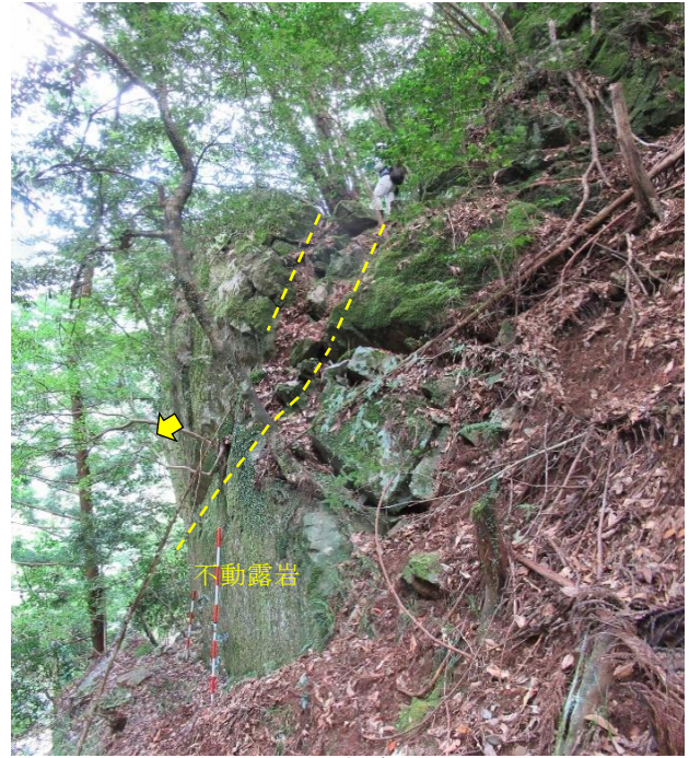
同左，頭部陥没帯
