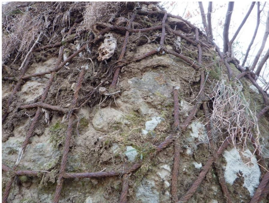
○ワイヤーモッコの腐食
