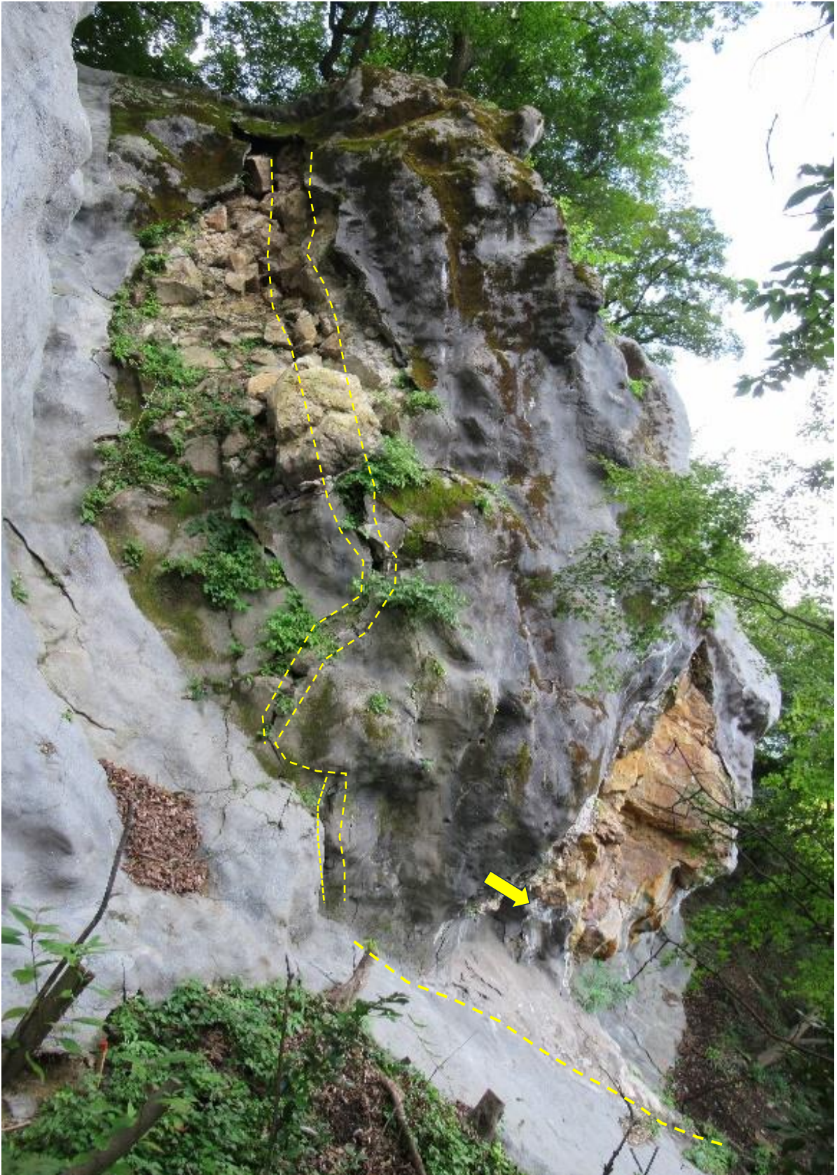
冠頭部キレツ：高さ 15m，傾斜 80°，剥離幅 20cm 程度以下
