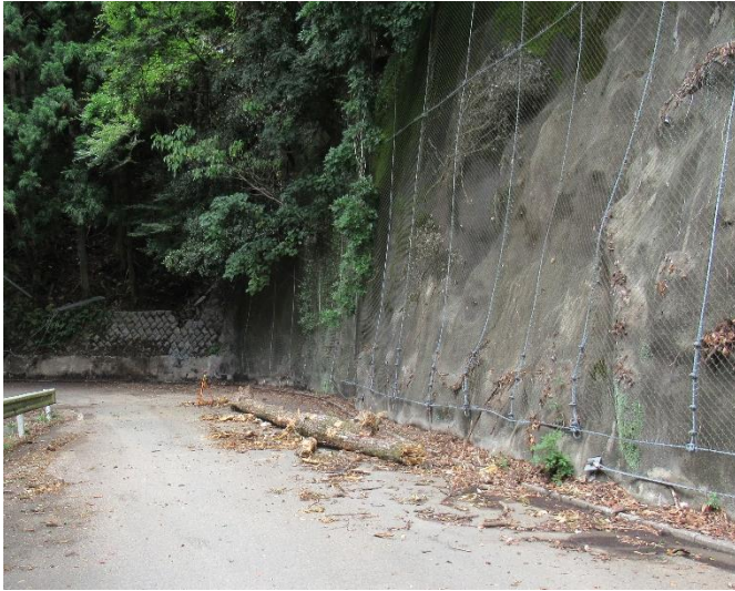
枯損木の落下
