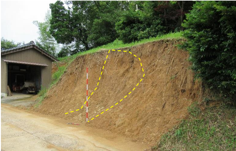
崩壊直後の状況（流出土砂撤去後）
