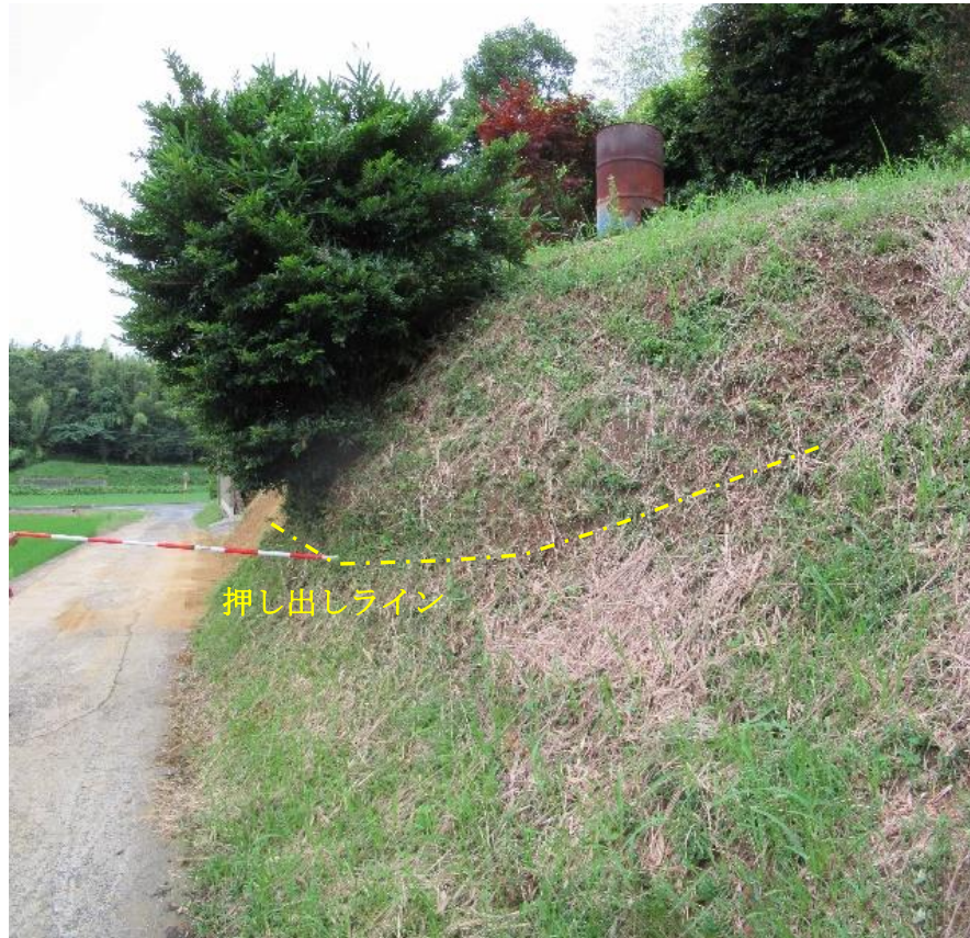
隣接斜面の変状 （非滑落斜面）
