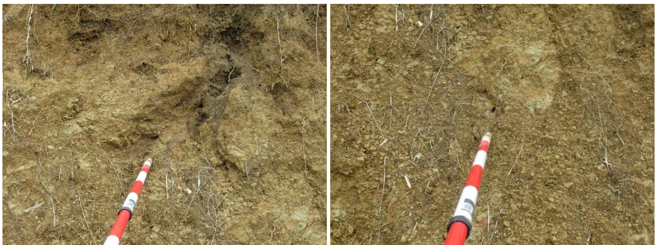
崩壊誘因と思われる地下水の噴出孔
