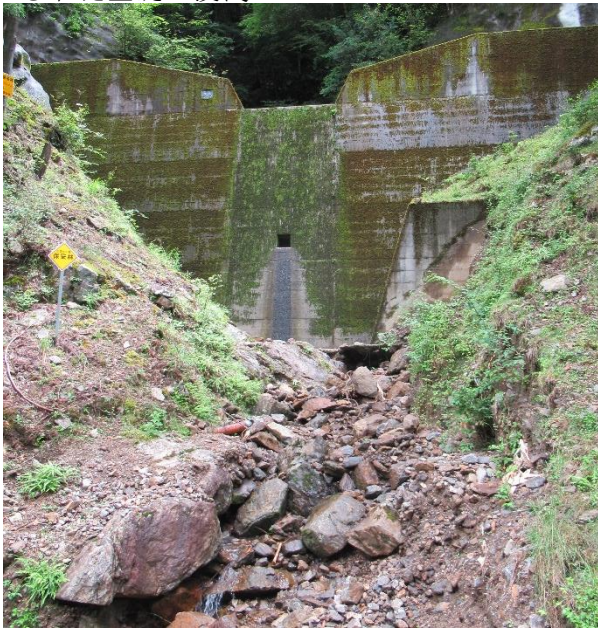
○堰堤基礎の浸食
