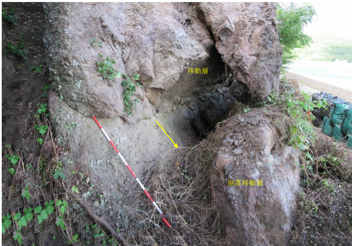
火砕岩層内のすべり面：すべり面粘土および地下水なし
