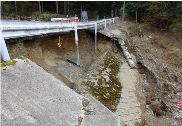
図 5.4 路体の崩壊 道路盛土部？の崩壊（延長 10m）
