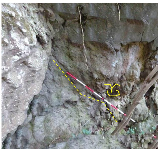
図 5.2 右岸側末端側壁部のすべり面と湧水（すべり面粘土なし）
