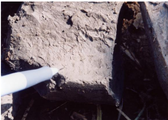
写真-1 アンカー孔壁の粘土化状況
