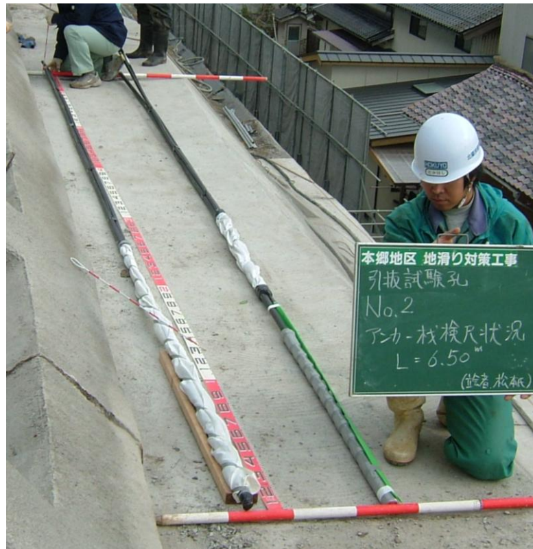
写真 3.2.1 試験用アンカー体組立加工状況（300Ws 型） 右：アンカー体拘束具とパッカー取り付け状況（標準タイプ） 左：グラウト逸出対策として、アンカー体全体を布パッカーで被覆したもの
