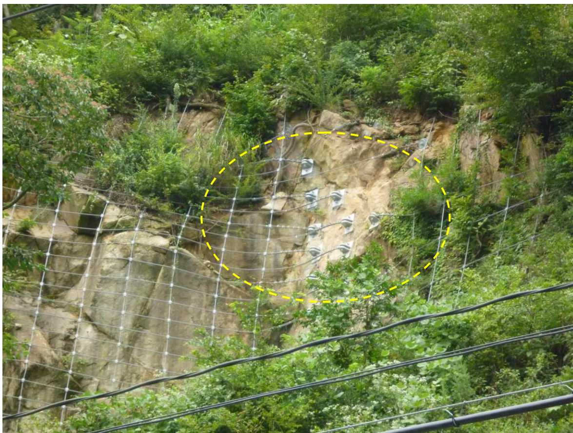
○高エネルギー吸収落石防護網工（～8000kJ）
