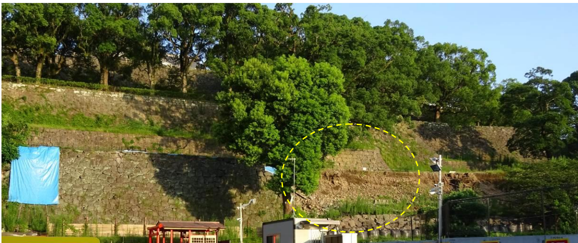
石垣の局所的な崩れ
