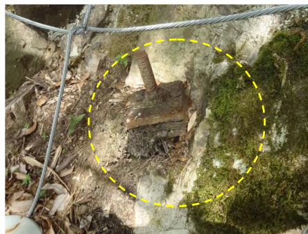
写真一参 1.4.1 D22 の腐食状況 (山間部道路法面) (施工後 20 年程度経過)
