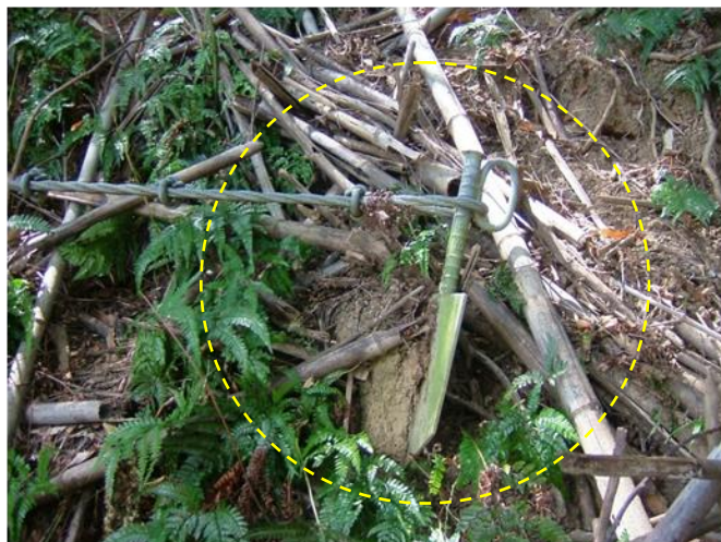
写真-参 1.3.1 土砂用アンカーの引抜け状況 (施工後約 20 年)
