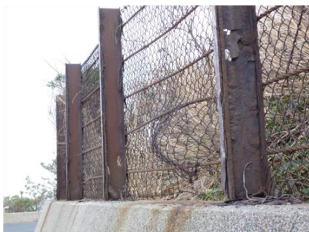
写真一参 1.4.1 海岸沿いに設置した H 形鋼の腐食状況 (施工後 20 年程度経過)
