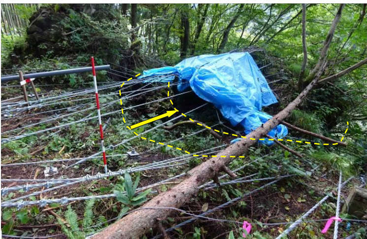
写真-参 1.6.2 地震により 2.5m 移動した急点付近の転石（ \phi 6.3\text{m} ）
