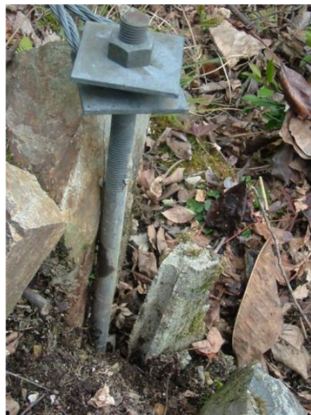
写真-参 1.3.2 岩用アンカーの剥離状況 (施工後約 20 年)
