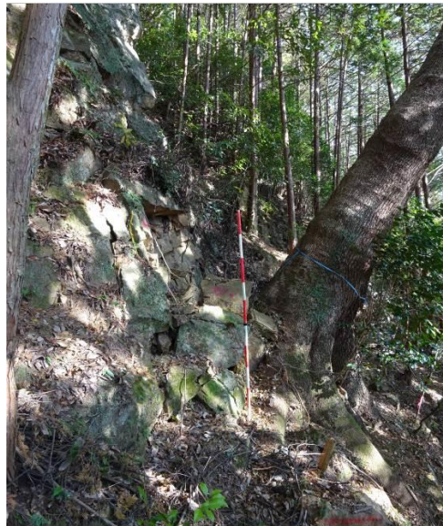
倒木による剥離
