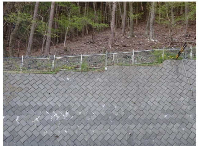
単管パイプと金網(パネル)を利用した防護柵(長野県)． ナイス！
