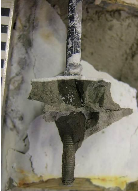
写真一参 4.3.6 引張型：定着材の剥離状況
