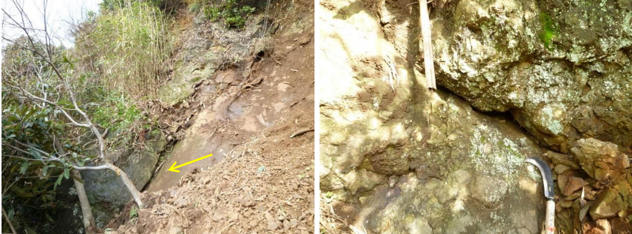
写真 8 地すべり面(末端部崩壊地内)
