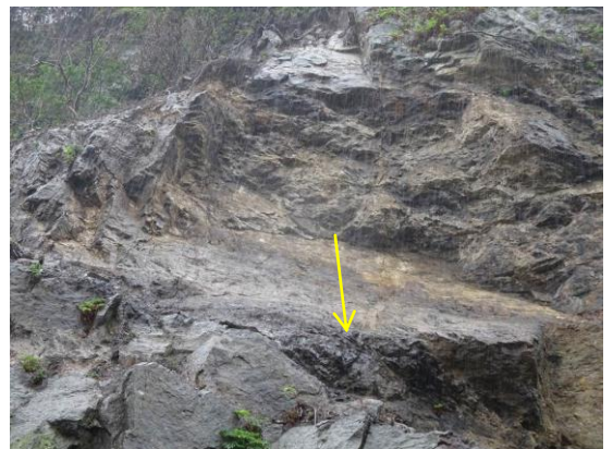
写真5 岩盤崩落 すべり面下部半分程度が変色しており、末端部から徐々に破断面が形成されていたことが分かる（島根県出雲市）。
