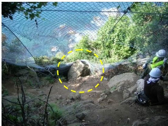
写真-参 3.3.1 落石防護網を直撃、破損せしめた転石
