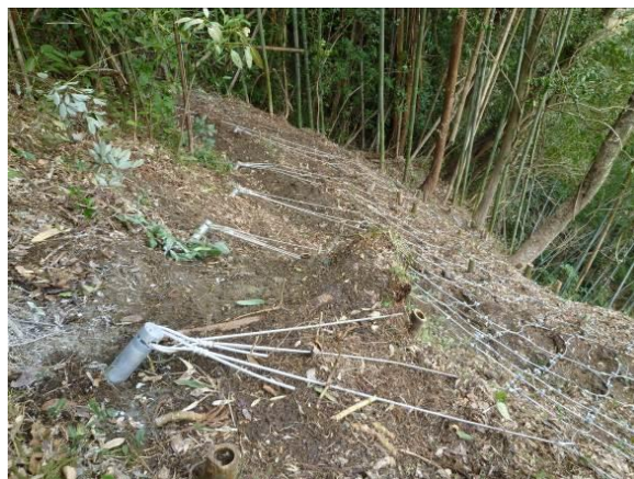
写真-参 3.1.2 同左, 巨岩周囲に設置した深層アンカー (削孔長 1.8m, 削孔径 65mm, 定着長 0.4m, 人力施工)
