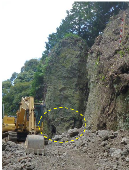
柱状の浮岩塊脚部は座掘状態 (円内)
