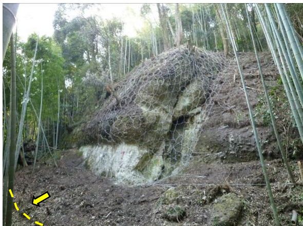
写真-参 3.1.1 層厚 3m, 斜面長 25m の巨岩 (スランプ状態) の固定
