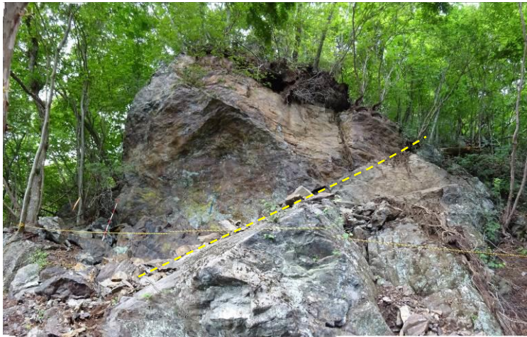
写真-3.2.8 地すべり末端崩壊にともなう落石 (点線はシーティング節理面)
