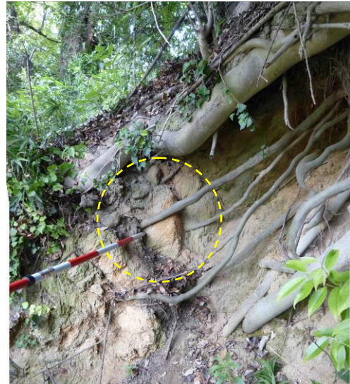
写真-3.2.5 同左，風化花崗岩内の侵入状況
