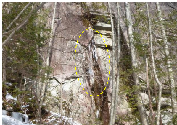
写真-3.2.12 凍結(円内)による剥離
