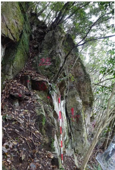
写真-3.4.2 バックリングによる崩落
