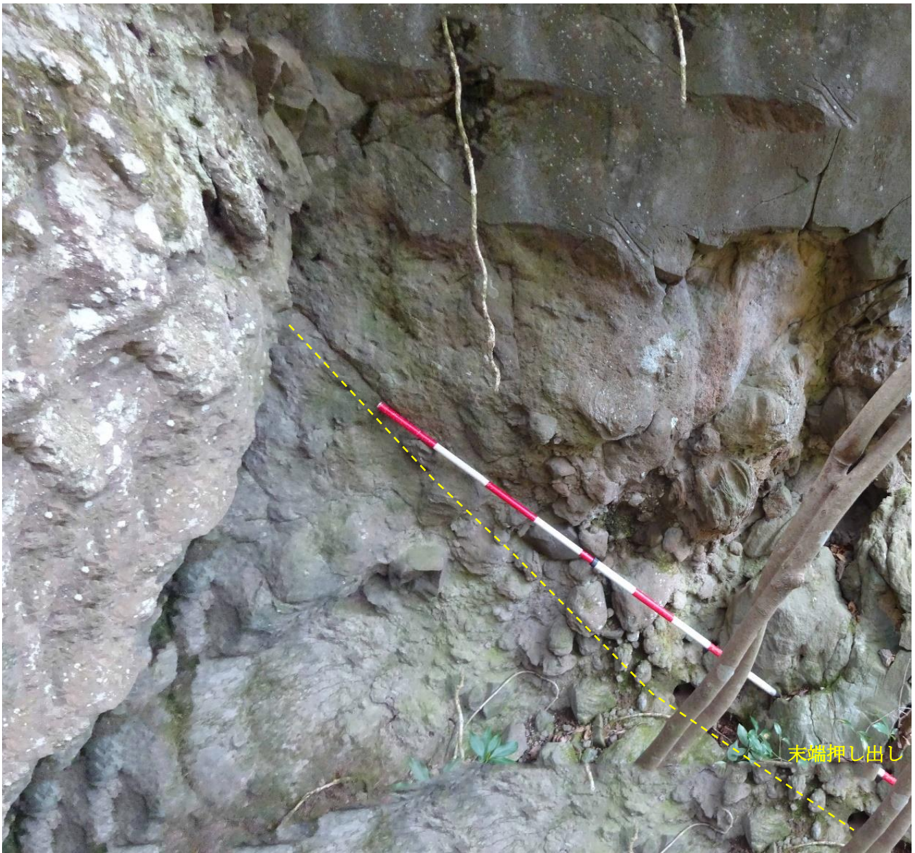
すべり面と判断される破断面・・・右岸側末端付近、滲むような湧水有り
