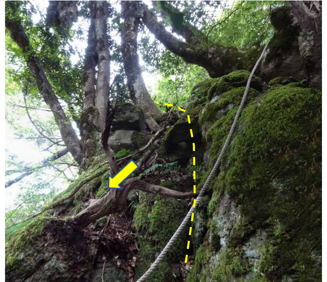
冠頭部剥離面（根系による剥離→滑動？）
